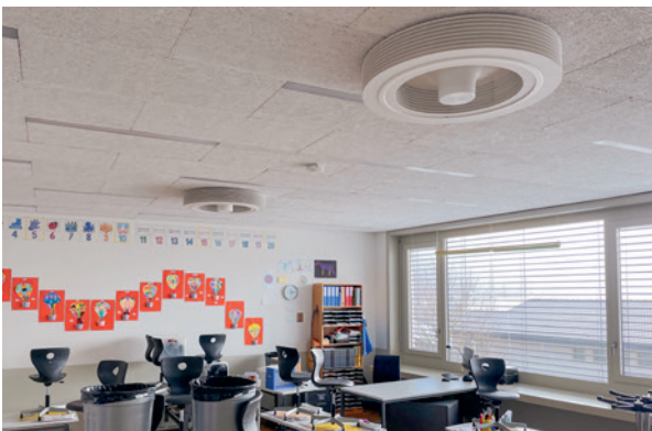
Deckenventilatoren in einem Schulzimmer der Primar
